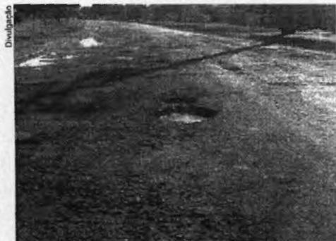
Decisão responsabiliza a administração pública pela existência de buracos e colocar a população em risco de vida, danos físicos e prejuízos materiais
