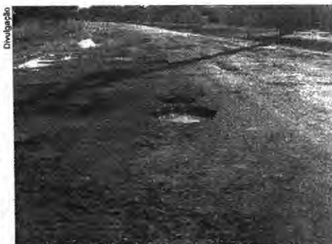
Decisão responsabiliza a administração pública pela existência de buracos e colocar a população em risco de vida, danos físicos e prejuízos materiais
